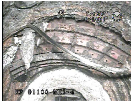
破損した下水道管路
