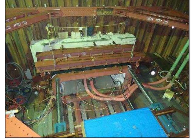
函渠内推進設備
