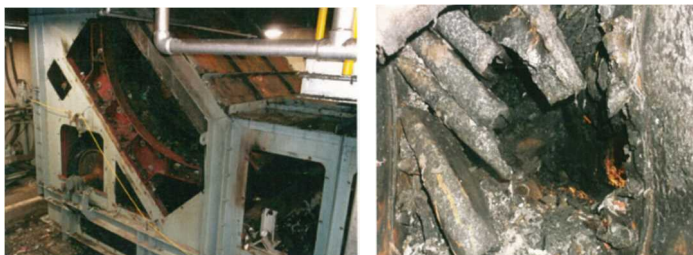
火災事故により損傷した不燃ごみベルトコンベア（平成 28 年度）
