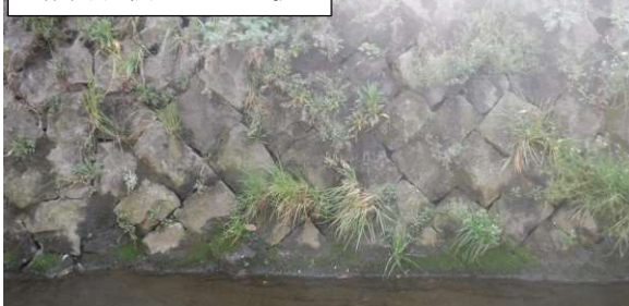
雑割石積 目地欠損
