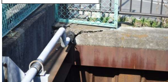
笠コンクリート 欠損
