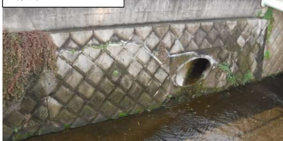
護岸 クラック
