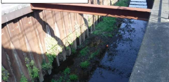
河床 土砂堆積
