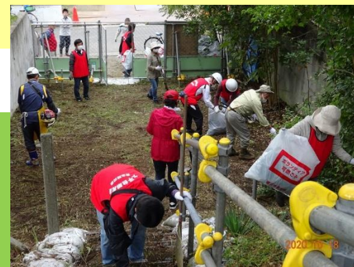
津波避難場所の設置(辻堂地区)
