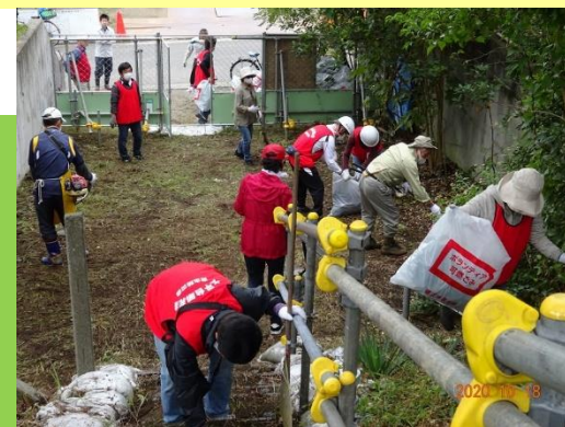
津波避難場所の設置(辻堂地区)
