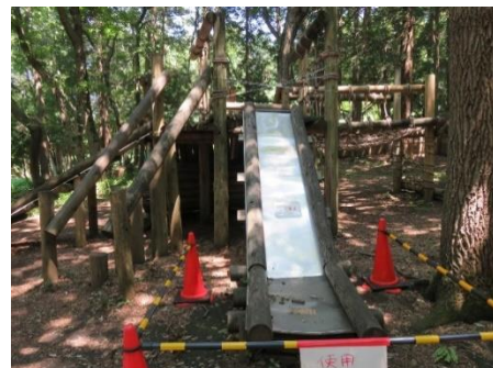
（修理中のアスレチック遊具）
