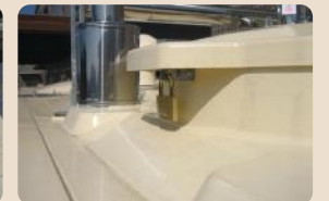
マンホール蓋施錠例
