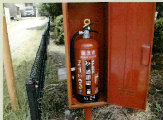
しょうかき 消火器 [3-110]
