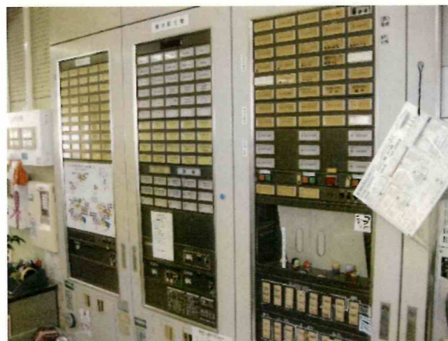
火災警報制御パネル 自動火災報知設備の受信盤 [3-90]
