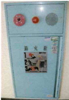
屋内消火栓設備 [3-88]
